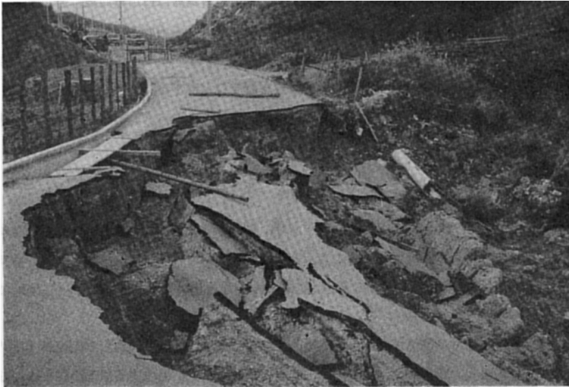
第59図 地すべりによる道路崩壊（神戸市北区有野町） Cracks and ruptures on the road, at just the head point of landslide.
